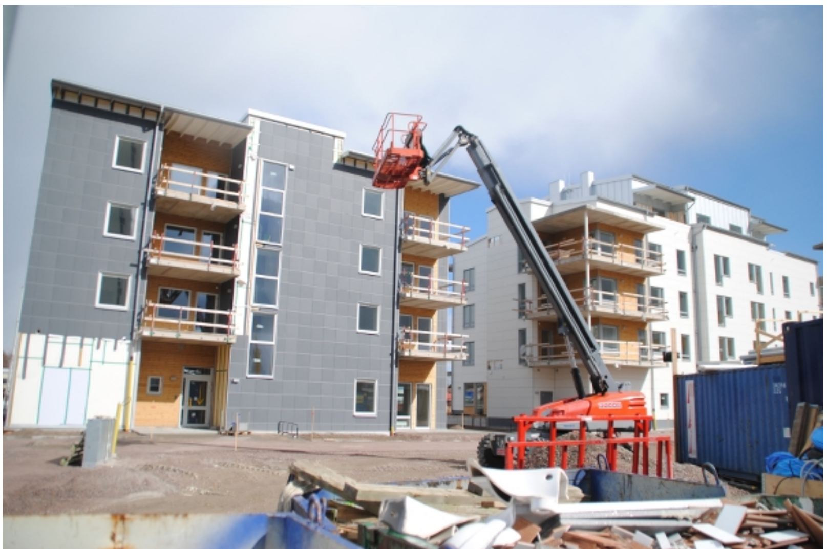
Fel, brister och skador i byggandet kostar samhället upp mot 111 miljarder kronor om året. Foto: Mostphotos
